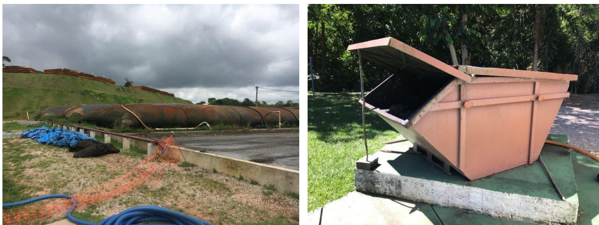
Figura 23 - Armazenamento e desidratação ETE Centro e caçamba para armazenamento de materiais retirados no tratamento primário da ETE Sana.
