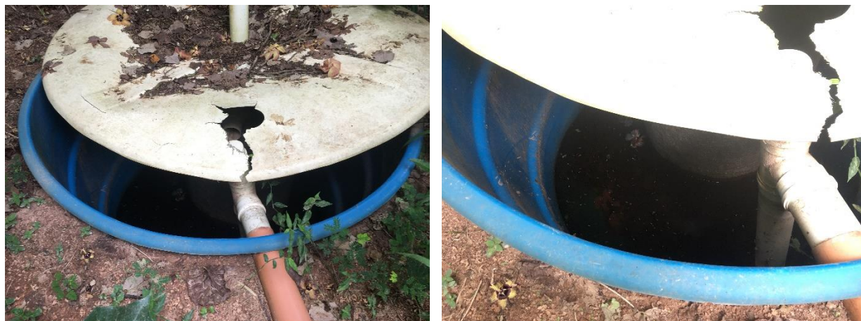
Figura 30 - Tanque de fossa séptica
